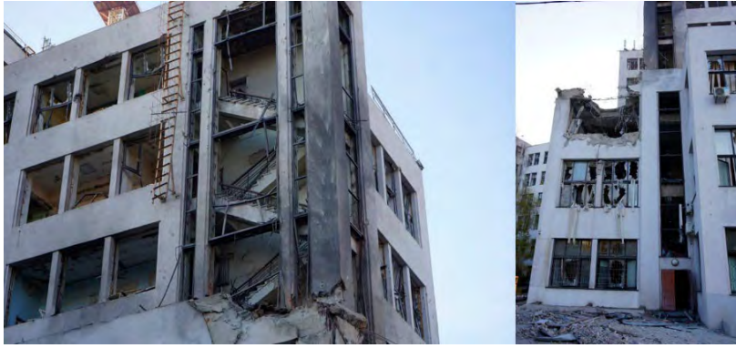
Рис. 3. Пошкодження частини корпусу № 3. Автор фото: В. Дворніков, жовтень 2023
