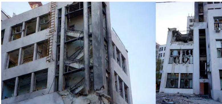
Abb. 3. Schäden an einem Teil des Gebäudes Nr. 3. Foto des Autors: W. Dwornikow, Oktober 2023
